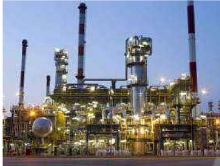
محطة توليد الكهرباء في الجبيل
