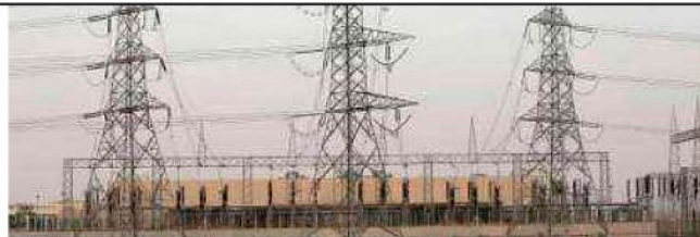
محطة سدير لتحويل الكهرباء
